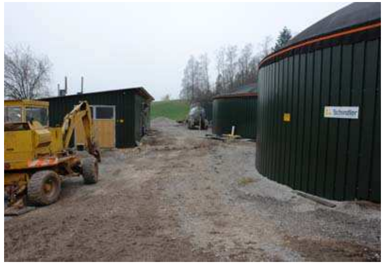
Im BHKW wird aus dem Biogas Strom erzeugt und die Abwärme zu Heizzwecken genutzt
